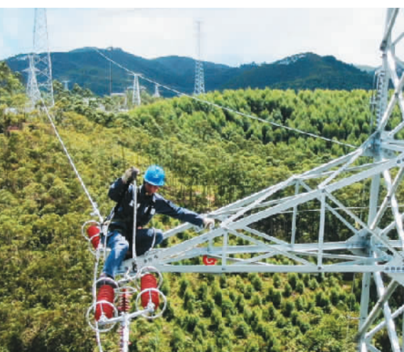
南方电网广西北海供电局积极推进配电网建设和智能化升级，增强电网分布式清洁能源接入能力，为经济社会发展提供稳定、可靠电力。图为该局工作人员在进行清洁能源发电企业输电线路检修。 阳文志摄(人民视觉)
