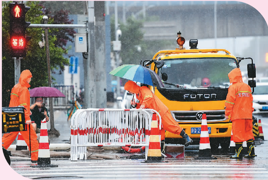
7月30日，在北京市朝阳区十里河桥附近，北京排水集团的工作人员在检查雨水井。新华社记者 鞠焕宗 摄
