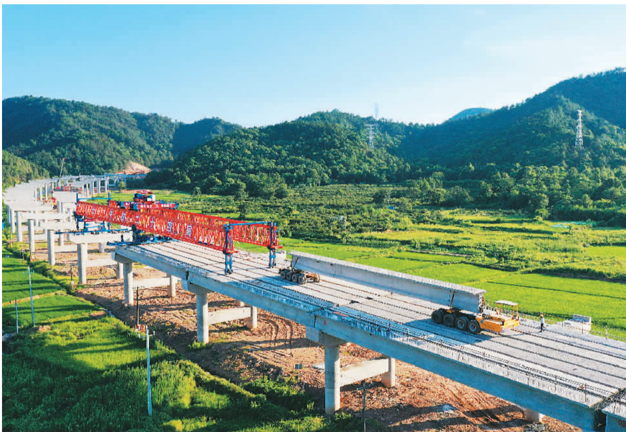
近日，在位于江西省抚州市东乡区孝岗镇坪里村附近，施工队员正在对东临环城高速公路的何家高架桥进行架设。东临环城高速公路项目全长约41公里，通车后有助于沿线一带产业结构优化升级和经济高质量发展。 饶方其摄（人民视觉）
