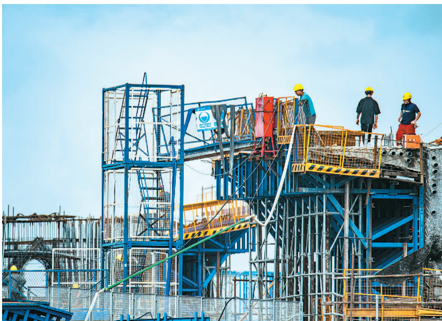
◀海南省琼海市G9812高速公路延长线工程项目工地，施工人员冒着高温烈日紧张施工。
