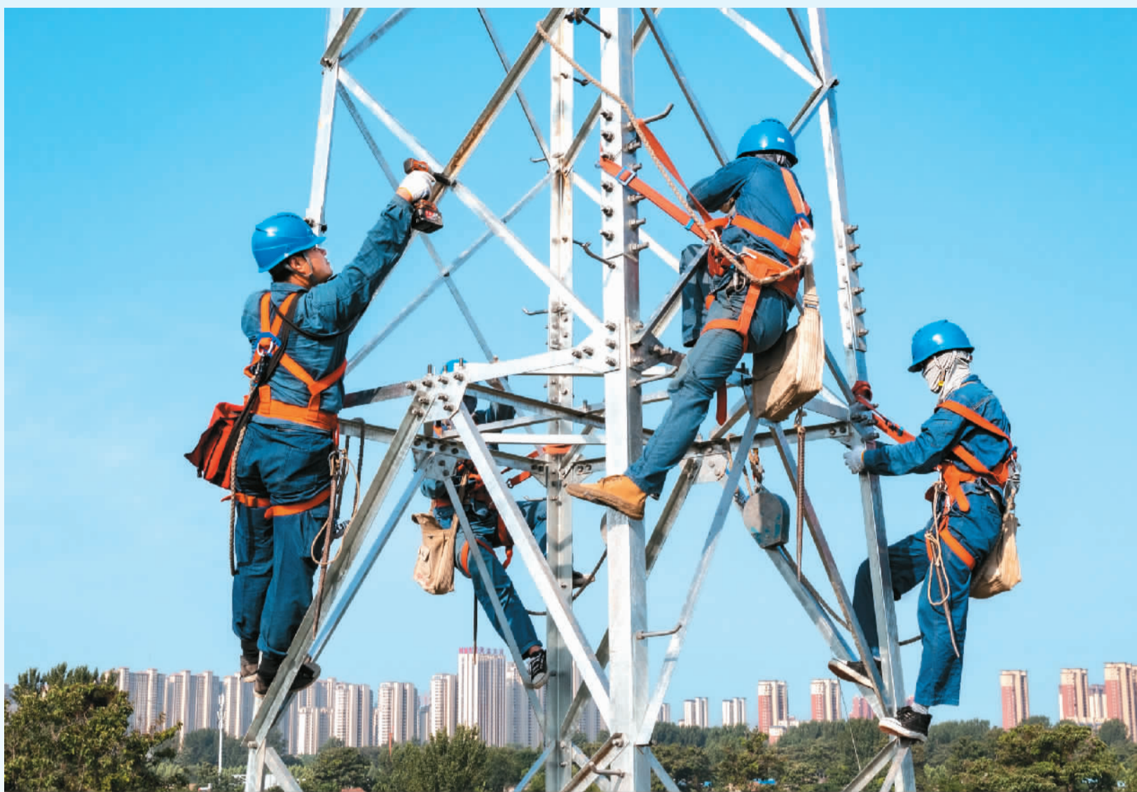
▲安徽省亳州市谯城区汤陵社区，电力施工人员正在吊立角钢塔。
