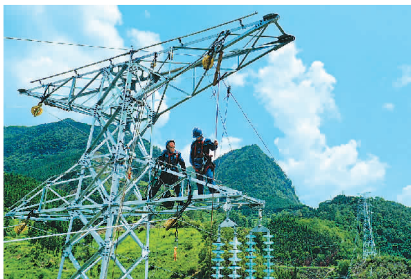
夏至以来,贵州省黔东南苗族侗族自治州兴义市遭遇持续高温天气,社会和工业用电负荷不断攀升。南方电网兴义供电局供电部门通过对220千伏、110千伏输电线路进行升级改造,优化电网结构,做好迎峰度夏保电供电工作。图为该局建设施工人员在输电线路铁塔上安装附件设备。 卢关文摄(人民视觉)
