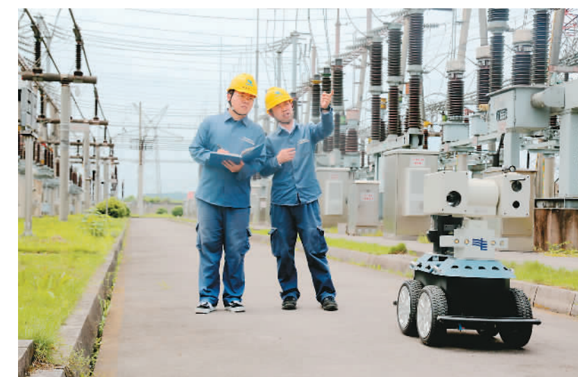
南方电网贵州电网公司依托贵州大数据产业发展的区位优势，大力推进数字电网建设。目前，贵州全省多个22千伏及以上变电站已投入使用智能机器人、变电设备巡视工作效率大幅提升。图为近日贵州电网公司铜仁供电局员工操作5G智能机器人对辖区变电设备进行巡视维护。 陈厦华摄（人民视觉）
