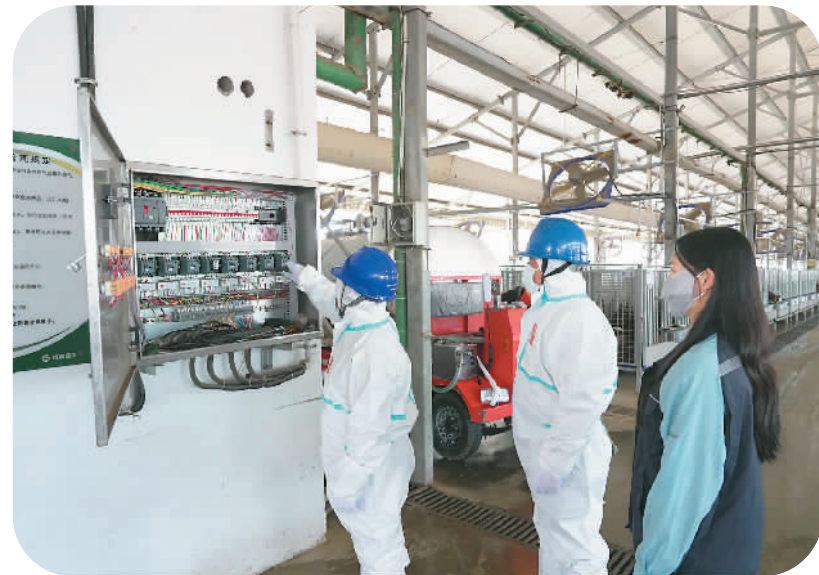
近日，国网山东烟台供电公司的工作人员来到龙口市某农牧科技企业开展上门服务，实时掌握企业用电需求，助推绿色低碳农业发展。图为身穿消毒服的电力工作人员在检查用电设备。张丽摄
