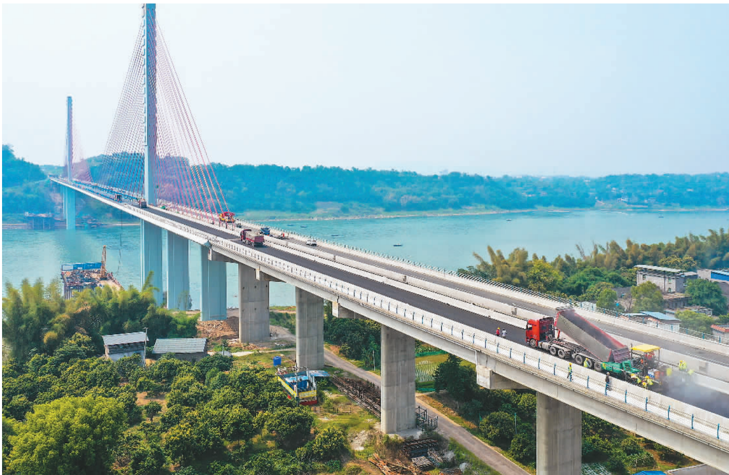
白沙长江大桥作为四川省泸州市重要的渡改桥项目, 在建成通车后, 将方便两岸三十万群众安全出行, 助推当地乡村振兴。图为五月四日, 工人在泸州市合江县白沙长江大桥上加紧沥青铺设。李贵平摄(人民视觉)
