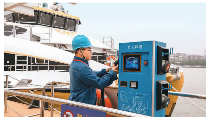
广东省广州市琶洲港澳客运口岸往返香港国际机场航线近日开始试运营。旅客从琶洲口岸乘船，可直达香港国际机场（海天码头）。为切实做好保障服务，南方电网广州供电局日前投入3台岸基船舶供电系统，为穿梭的客船提供交流用电。图为广州市供电局工作人员在现场测试岸基船舶供电系统。赵仲明摄
