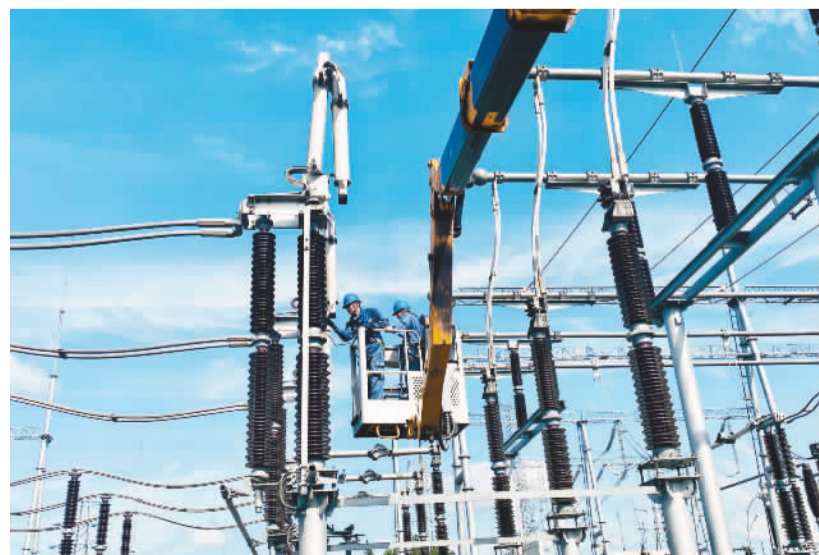
“五一”假期，在广西壮族自治区钦州市钦南区金窝工业园区，南方电网广西钦州供电局变电检修人员正在对辖区内的第一座数字化变电站——220千伏排岭变电站的设备进行检修维护，以提高设备健康水平，确保西部陆海新通道骨干工程平陆运河项目建设用电安全可靠。廖晓跃摄（人民视觉）
