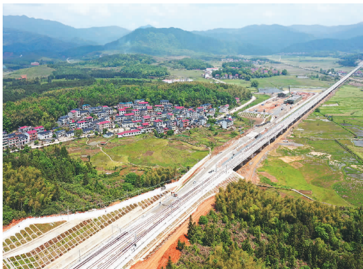
4月26日,昌(南昌)景(景德镇)黄(黄山)高铁全线铺轨贯通。昌景黄高铁建成通车后将连接杭(杭州)黄(黄山)高铁,有利于拉动沿线旅游产业发展。图为江西省景德镇市浮梁县境内建设中的昌景黄高铁。
