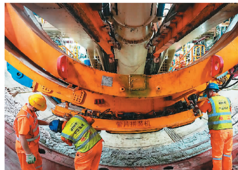
4月24日，广（广州东）花（花都天贵）城际铁路全线首台盾构始发，中铁十一局“铁兵广花13号”盾构机开始执行白云城市中心至白方盾构井区间右线隧道掘进任务。作为粤港澳大湾区城市轨道交通交通网的骨干线路，广花城际将和广州地铁十八号线、二十二号线、芳白城际及南珠（中）城际一起联通大湾区西岸重要区域和交通枢纽。图为技术人员检查“铁兵广花13号”盾构机的管片拼装机。新华社记者 刘大伟摄
