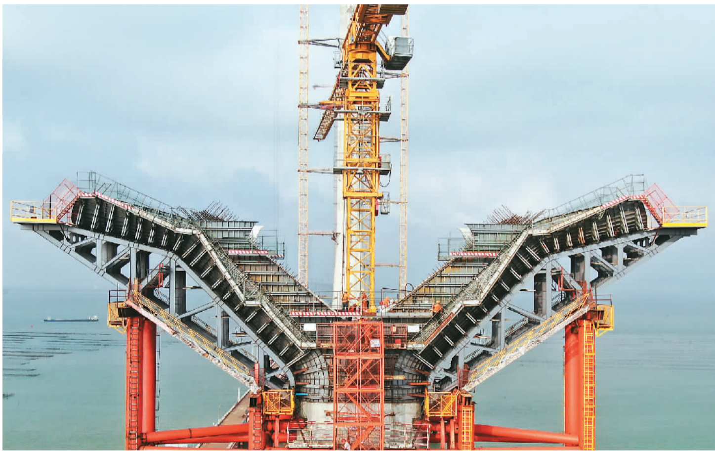
近日，由保利长大承建的黄茅海大桥中塔顺利封顶，至此，黄茅海跨海通道的高栏港大桥和黄茅海大桥共5座主塔全部封顶。黄茅海跨海通道起于广东省珠海市高栏港经济区，向西跨越珠江口崖门入海口黄茅海水域，终于江门市斗山镇，线路全长约31公里，预计2024年建成通车。图为黄茅海大桥墩柱基桩建设现场。新华社记者 邓华摄
