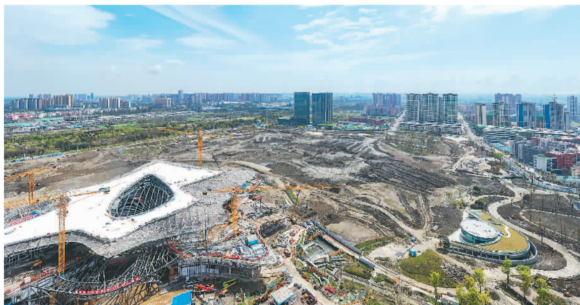
眼下，第81届世界科幻大会配套工程世界科幻公园在四川成都加紧建设，各道工序陆续穿插进行，整体工程预计于今年8月底竣工。据了解，世界科幻公园项目设计总面积约1314亩，包括动力广场、科幻宇宙区、星球乐园等。图为世界科幻公园建设现场。
