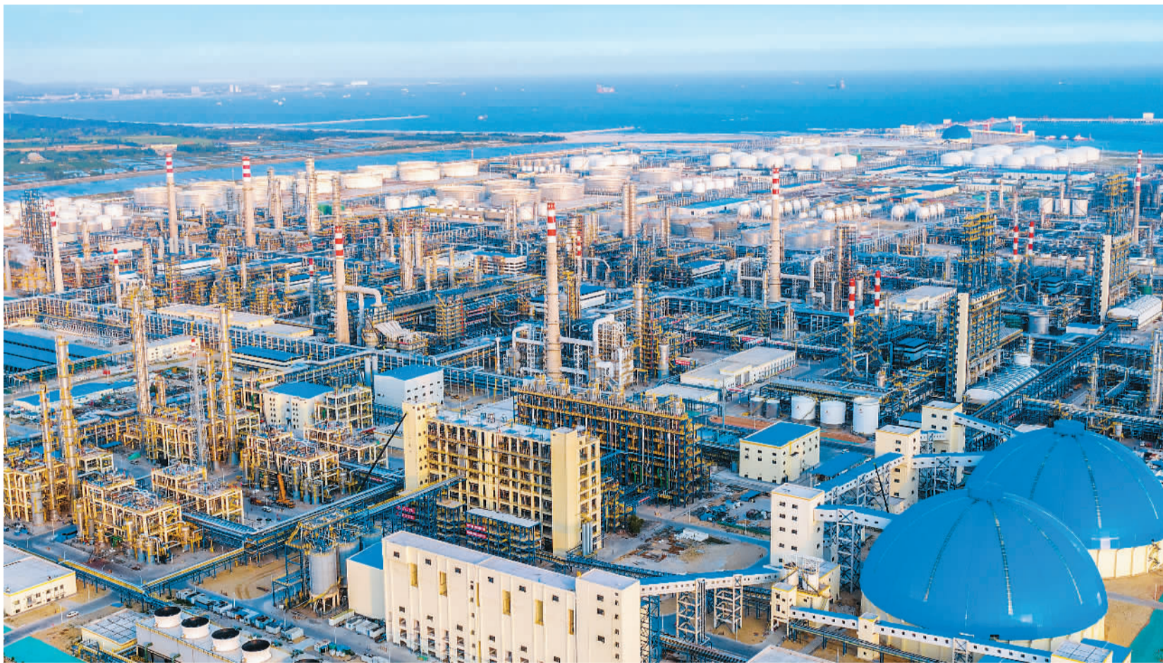
2月12日，千万吨级炼化一体化项目——中国石油广东石化炼化一体化项目的120万吨/年乙烯装置投料试车成功，这标志着广东石化打通炼化一体化项目全流程，进入全面试产阶段。120万吨/年乙烯装置是目前国内自主技术最大规模国产化乙烯装置。
