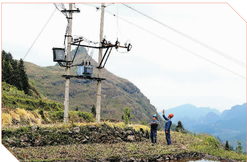
▲ 2月1日，为保障春耕用电，在贵州省黔东南布依族苗族自治州，南方电网贵州兴义晴隆供电局工作人员走进田间巡检，确保配电设备安全稳定运行。
