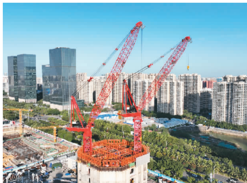
由中建三局承建的海南中心项目位于海南省海口市琼山区国兴大道南侧，是集观光、酒店、写字楼、商业等多功能于一体的超高层综合体。图为工作人员操作塔吊施工。 卢传健摄
