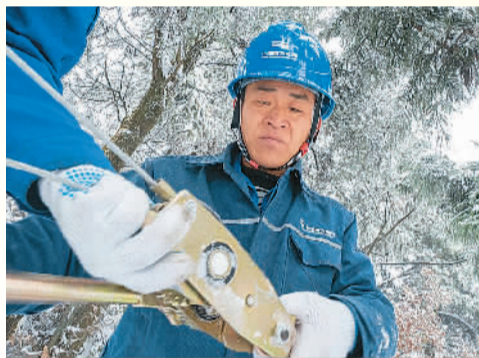
舒进正在检修电路。受访者供图
