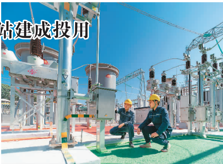
图为广州供电局员工在500千伏科北变电站现场检查设备。
