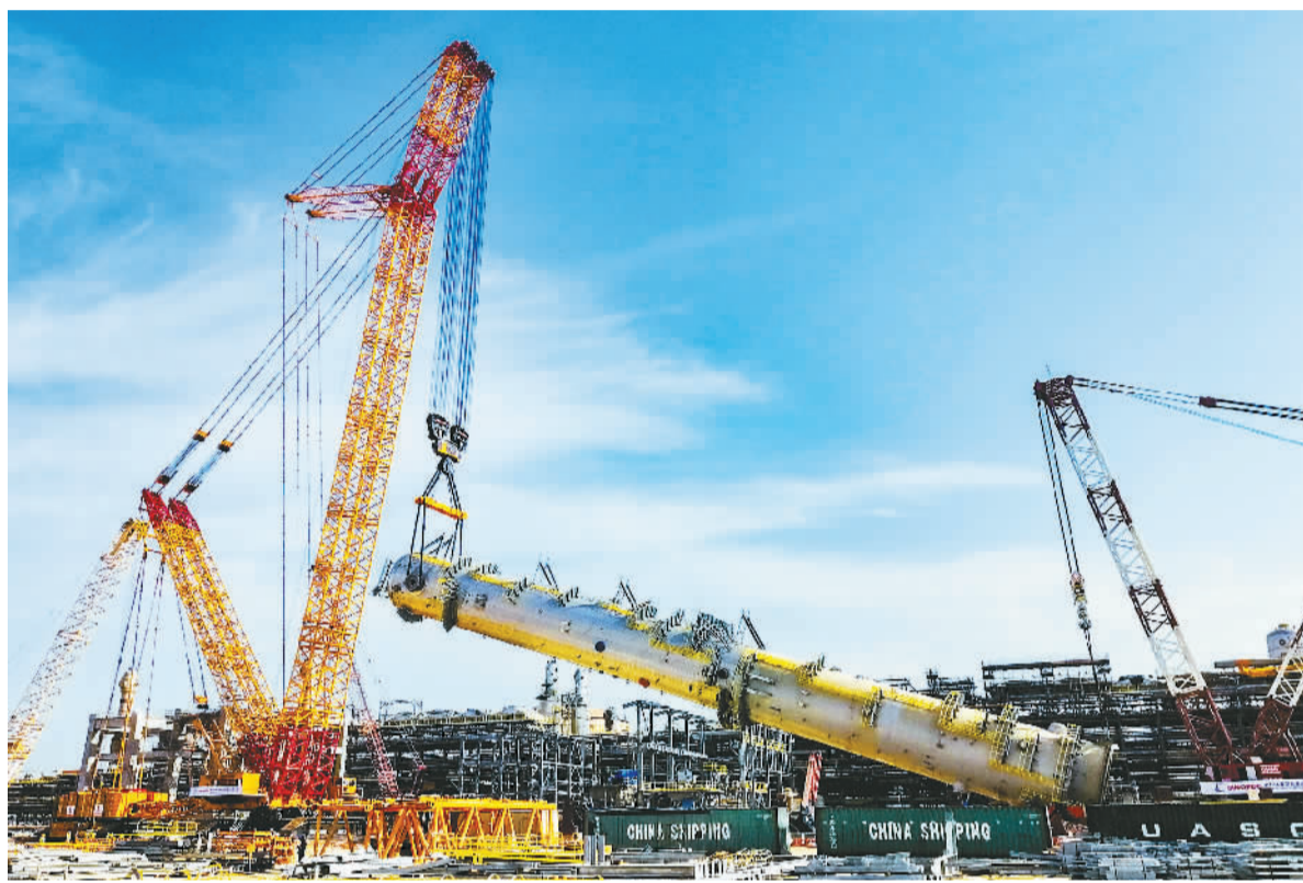
徐工集团4000吨级履带起重机XGC88000在沙特达省米拜勒工业区项目建设现场。受访企业供图
