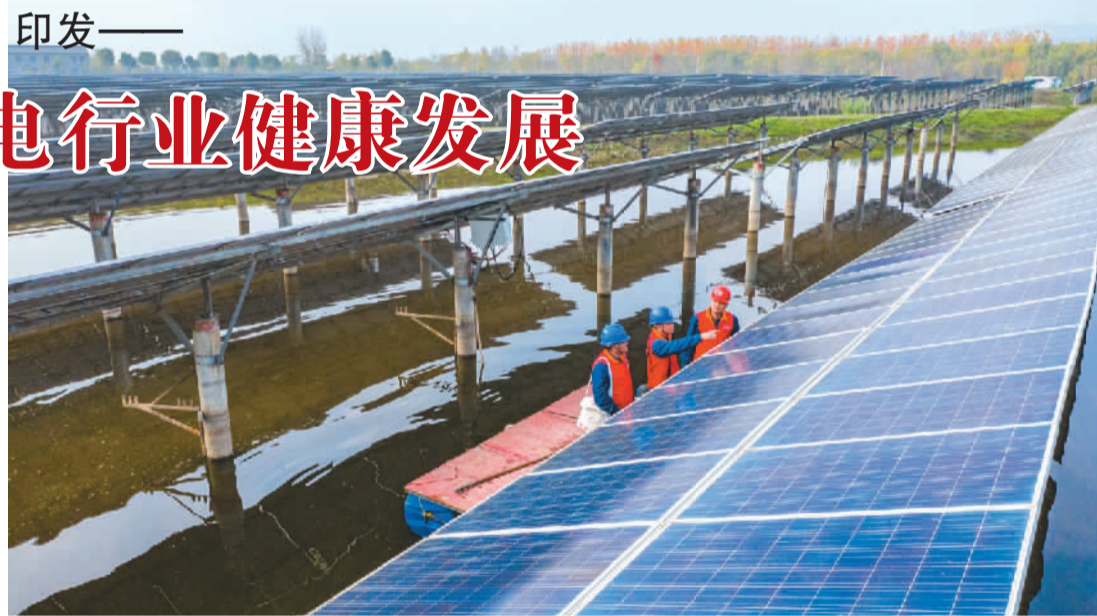
近年来，安徽省合肥市庐江县光伏发电产业进入快速发展时期，尤其是分布式光伏发展迅猛。今年累计完成并网418户，光伏并网容量达到9168.96千瓦，增长率相比去年提升302.8%。图为国网安徽庐江县供电公司员工日前对康捷光伏电站设备进行检修调试。 丁文康摄（人民视觉）
