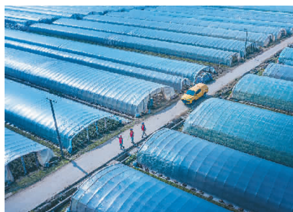
当前正值育苗关键时节，湖北省荆州市供电公司党员服务队对农业用电配线路、设备巡视检查，排查用电隐患，助力乡村振兴。 图为供电公司人员在大棚检查用电设备。 王超摄
