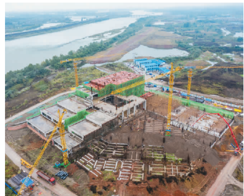
2022年10月，四川省眉山市彭山区岷江、府河交汇处，江口沉银博物馆项目正在施工。
