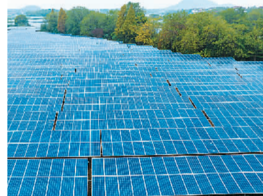
11月21日，浙江省金华市兰溪永昌绿能光伏企业太阳能光伏发电变电压输电成功并网。 杨梅清摄（人民视觉）
