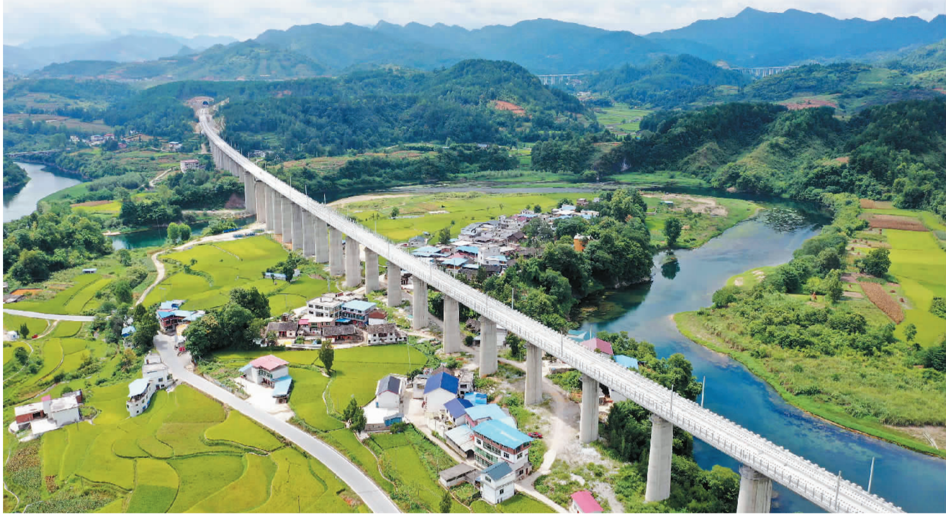
图为贵(阳)南(宁)高铁盘清水河双线特大桥建设现场。贵南高铁设计时速350公里,是我国“八纵八横”高铁网主通道包头至海口通道的重要组成部分。
