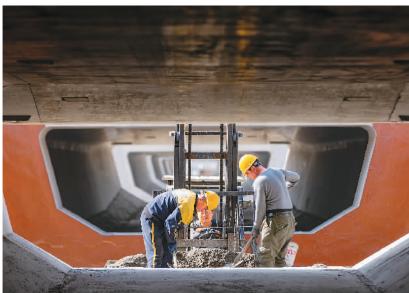
9月21日,集(宁)大(同)原(平)高铁内蒙古段,工人正在紧张施工作业。夏亮摄(人民视觉)
