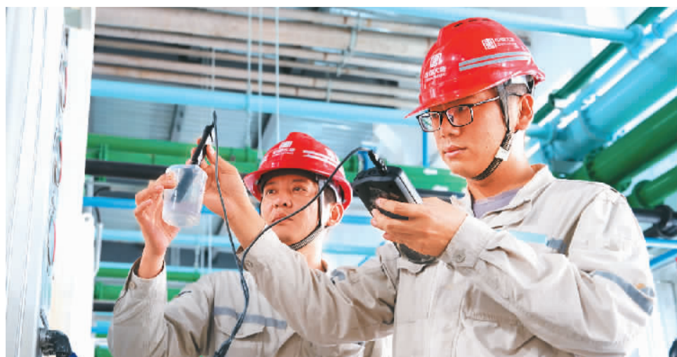
大唐东营发电有限公司采用反渗透技术对海水进行淡化处理，其海水淡化系统淡水产量达到8640吨/日，投运后累计产水250余万吨，较好解决了企业用水需求。图为近日，工作人员对海水淡化设备进行检测。郭俊锋摄（人民视觉）
