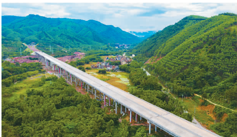
广西壮族自治区平南至武宣高速公路建设正加速推进。该项目全长62.837公里，采用双向四车道高速公路建设标准，设计行车速度120公里/小时，是广西高速公路网的重要组成部分。图为近日由中建路桥集团有限公司承建的平武高速公路航拍画面。
