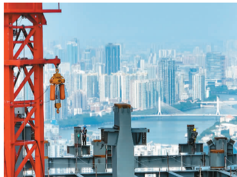
正在建设中的广东省广州市琶洲人工智能与数字经济试验区是广深港澳科技创新走廊核心平台之一。建成后，它将成为互联网、高科技等新兴产业集聚地和广州深度参与粤港澳大湾区建设的重点平台。图为建设者在高空开展作业。陈志强摄（人民视觉）
