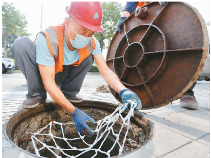
在山东省泰安市，施工人员正在为窨井加装安全防坠网。陈阳摄（人民视觉）
