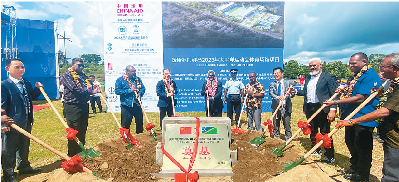
今年4月，中国援建的所罗门群岛2023年太平洋运动会体育馆项目练习跑道和足球场正式完工并交付所方。图为开工奠基仪式现场。
