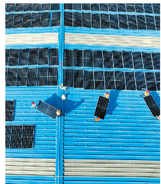
6月30日，湖北省十堰市房县北城工业园区厂房屋顶，施工人员在安装太阳能电池板。
