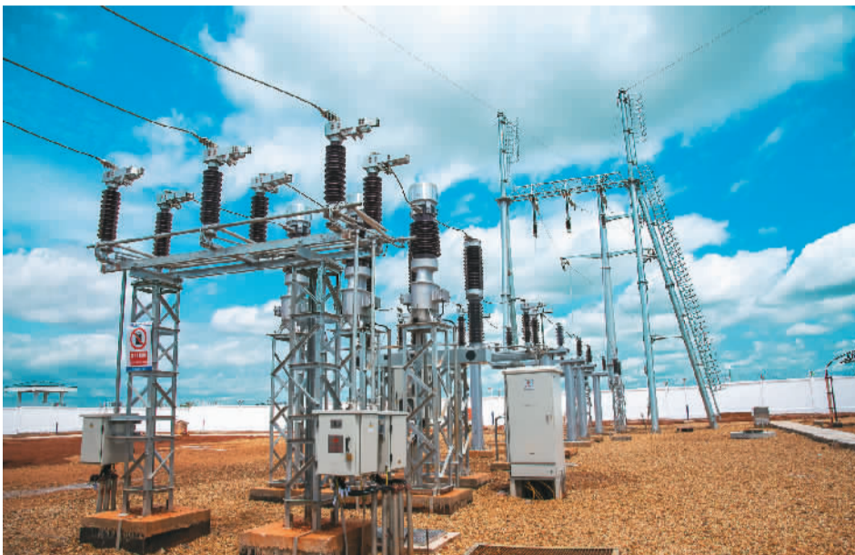
萨卡伊光伏电站是中非共和国首座光伏电站。该电站位于该国首都班吉附近的宾博市，由中国能源建设集团天津电力建设有限公司总承包，装机容量为15兆瓦，其落成极大缓解了班吉的用电难，促进了当地社会经济发展。图为6月2日拍摄的萨卡伊光伏电站升压站。
