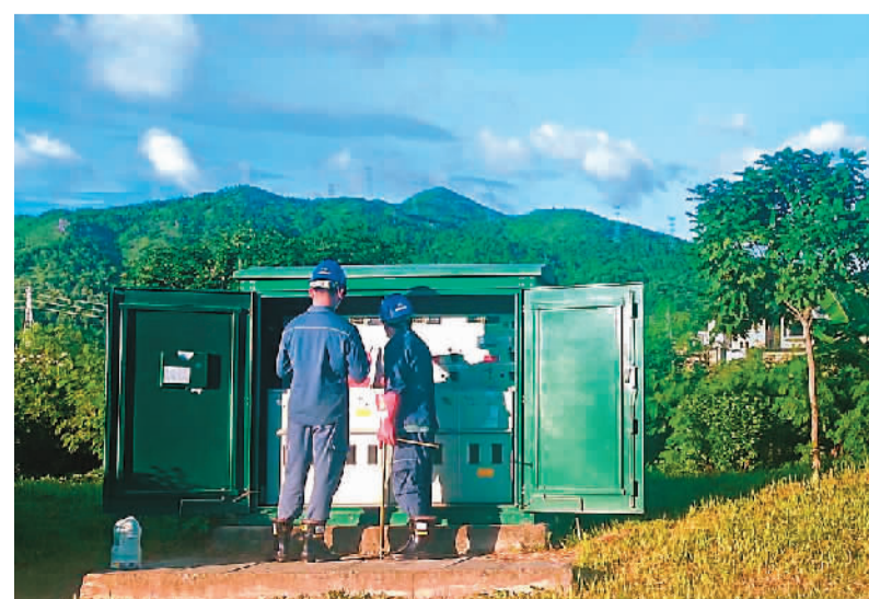
日前，南方电网广东汕尾城区供电局对10千伏大华线进行线路改造，实现10千伏大华线、石洲线两条线路“手拉手”供电，大幅度减少辖区内的停电风险，进一步保障用户用电。 邱思侠摄
