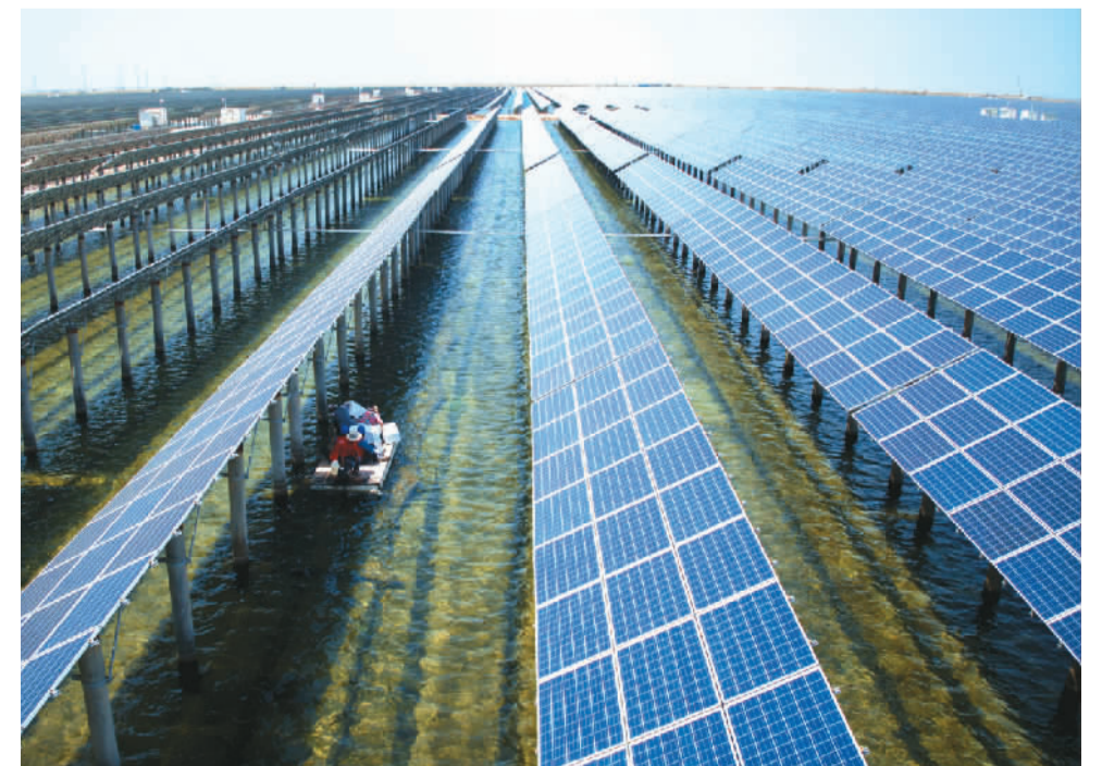
山东省东营市河口区充分利用立体空间，融合“风、光、海、渔”等资源要素，大力发展光伏发电、风力发电等绿色新能源产业，实现经济、生态双丰收。目前，河口区新能源发电装机容量达118万千瓦，新能源年发电量突破18亿千瓦时。图为位于河口区百亩生态渔业区浅滩内的曙光汇泰渔光电站，当地供电公司工作人员乘船巡检光伏设备。党秀娟摄（人民视觉）
