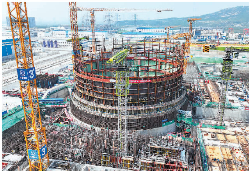
图为位于江苏省连云港市连云区的田湾核电站7号机组建设现场。
