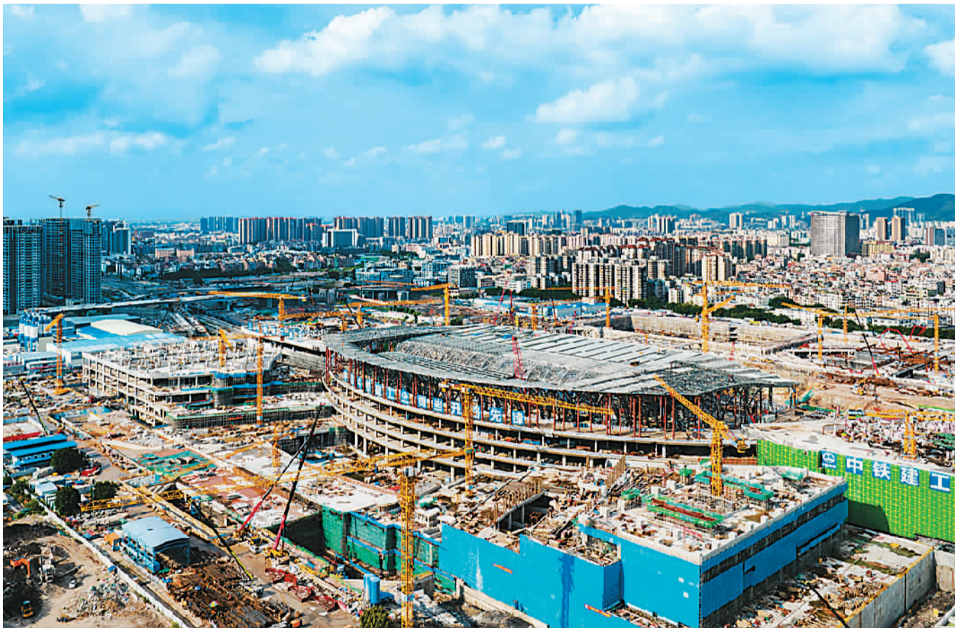
近日，广东广州白云火车站建设现场如火如荼，工人们正加紧施工。广州白云火车站是粤港澳大湾区的重点工程，该项目建成将成为具有岭南特色的大型综合交通枢纽。图为建设中的广州白云火车站。魏松松摄（人民视觉）
