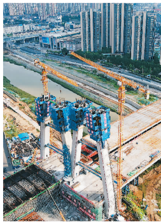
7月22日, 工人在中铁四局引江济淮工程江淮沟通段金寨南路桥项目现场错时施工。新华社记者 刘军喜摄
