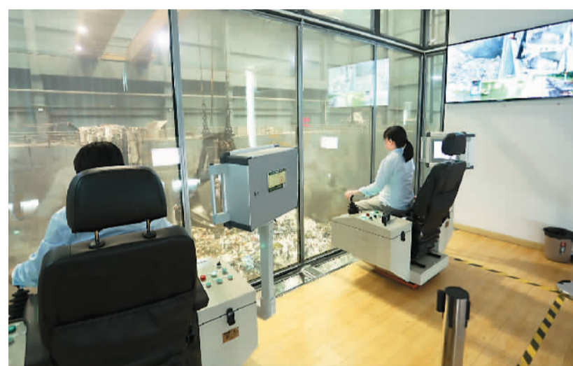
图为6月7日，在四川省眉山市仁寿县垃圾焚烧发电厂的垃圾吊控制室，工作人员正在操作垃圾焚烧工作。潘帅摄（人民视觉）
