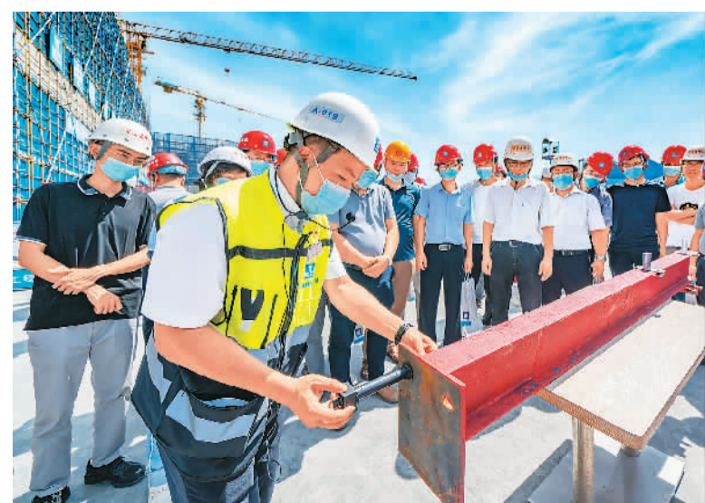
日前,2022年广东汕头市建筑施工“安全生产月”现场观摩交流会在中建八局南方公司汕头市中心医院易地重建项目举行,重点介绍降低安全隐患的新工艺。近年来,汕头市建筑行业坚持技术创新,通过科技手段降低工人在安装过程中的风险,保质保量完成工期进度。图为技术人员在讲解工字钢安装新工艺。 梁波摄(人民视觉)
