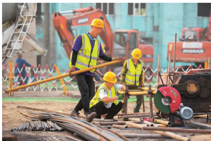
6月24日，内蒙古自治区包头市友谊十九小区改造现场，工人们在工地上忙碌。
