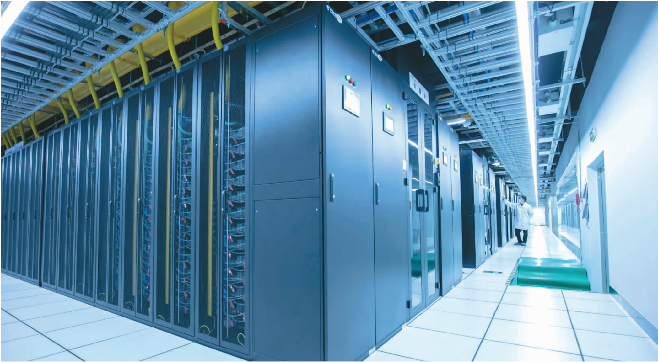
5月22日，在江西省九江市鄱阳湖生态科技城的中国电信中部云计算大数据中心机房内，机房巡检工程师正在察看服务器运行情况。
