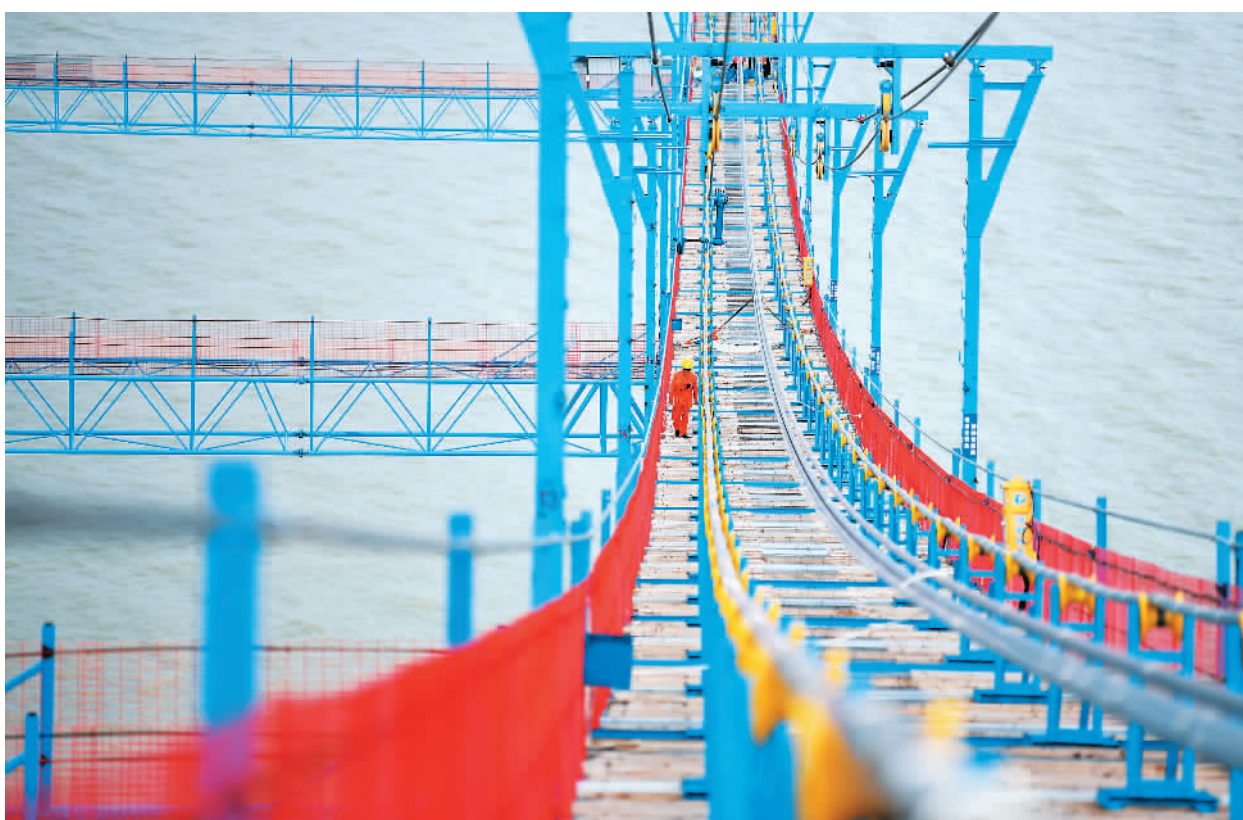
日前，工人在深中通道伶仃洋大桥海上施工猫道上作业。据了解，深中通道全长24公里，预计2024年建成通车，建成后将成为连接珠江口东西两岸的直联通道。新华社记者 邓华摄
