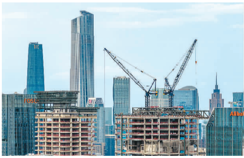
琶洲试验区是广深港澳科技创新走廊核心平台之一，是广州深度参与粤港澳大湾区国际科技创新中心建设的重点平台。图为琶洲人工智能与数字经济试验区，新大楼正加紧施工。魏勤松摄（人民视觉）
