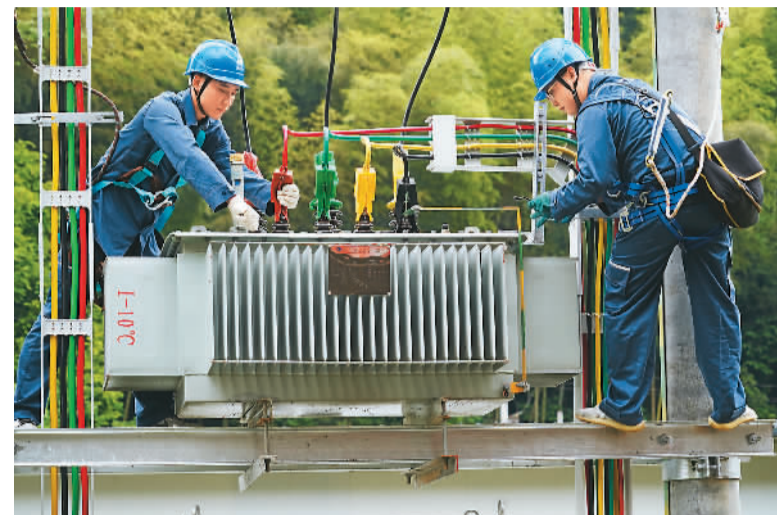
为确保复收时期农业生产用电，贵州省铜仁市江口县供电部门近来组织工作人员来到江口县粮食储备仓五里桥粮站，对用电线路进行全面巡查，及时消除隐患，并根据负荷增长情况对变压器进行扩容增容，保障复收粮食安全入库。图为南方电网江口供电局工作人员对该粮站辖区的变压器进行扩容增容作业。 吴瑾摄（人民视觉）
