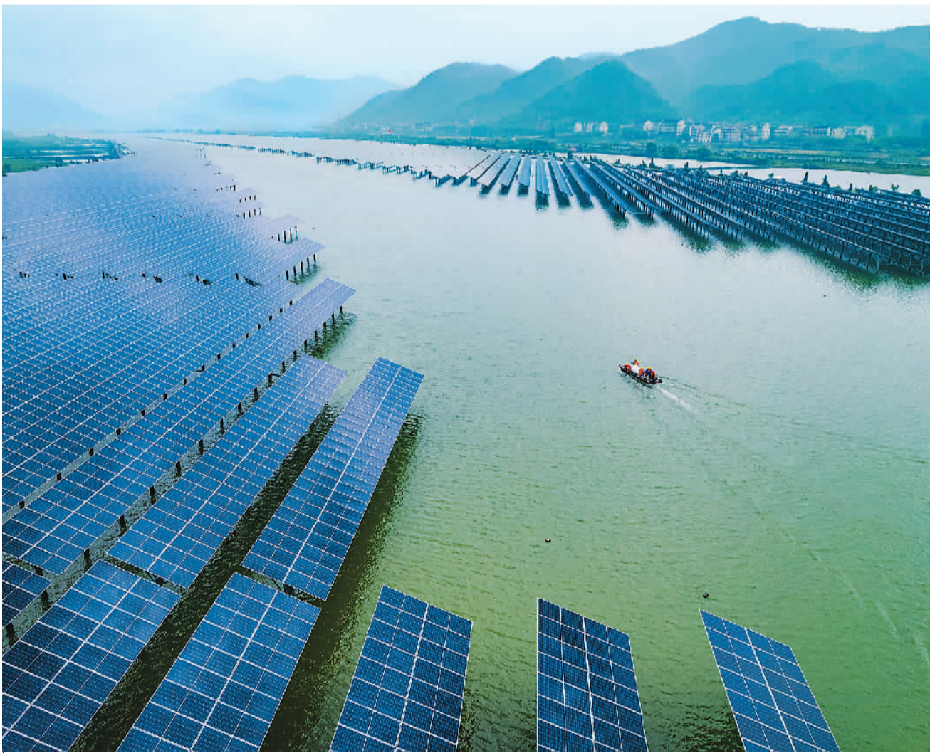
5月30日，全国首座潮光互补智能光伏电站——国家能源集团龙源浙江温岭潮光互补智能光伏电站正式投运，实现全容量并网发电。徐伟杰摄（人民视觉）
