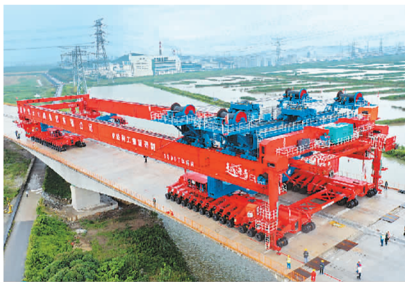
世界最大吨位1800吨级整孔预制箱梁架桥机“越海号”。中铁科工供图
