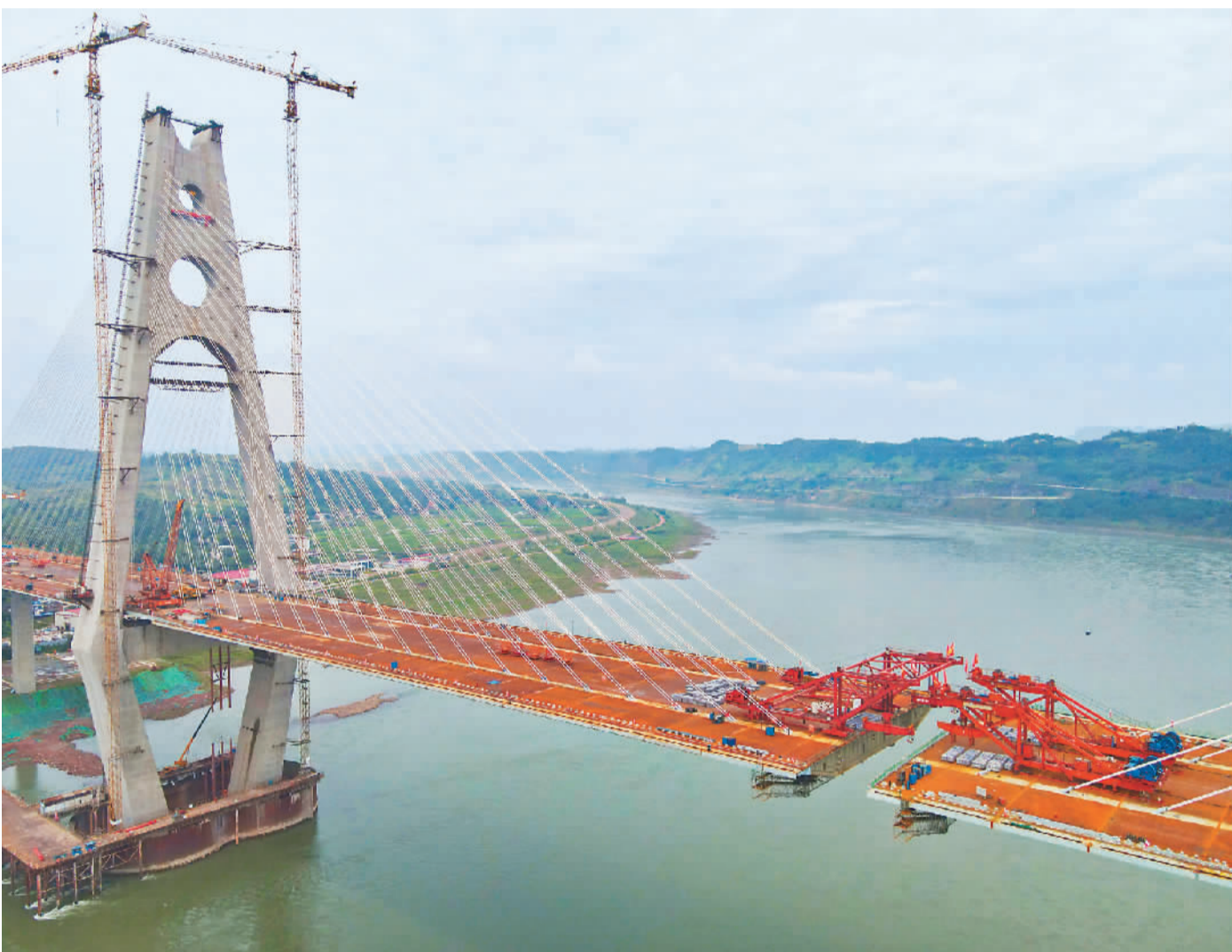
四川宜宾临港长江大桥是国内首座高铁与公路双层布置的斜拉桥，世界最大跨度的公铁两用钢箱梁斜拉桥。按照施工计划，将于本月底合龙。图为即将合龙的宜宾临港长江大桥。
