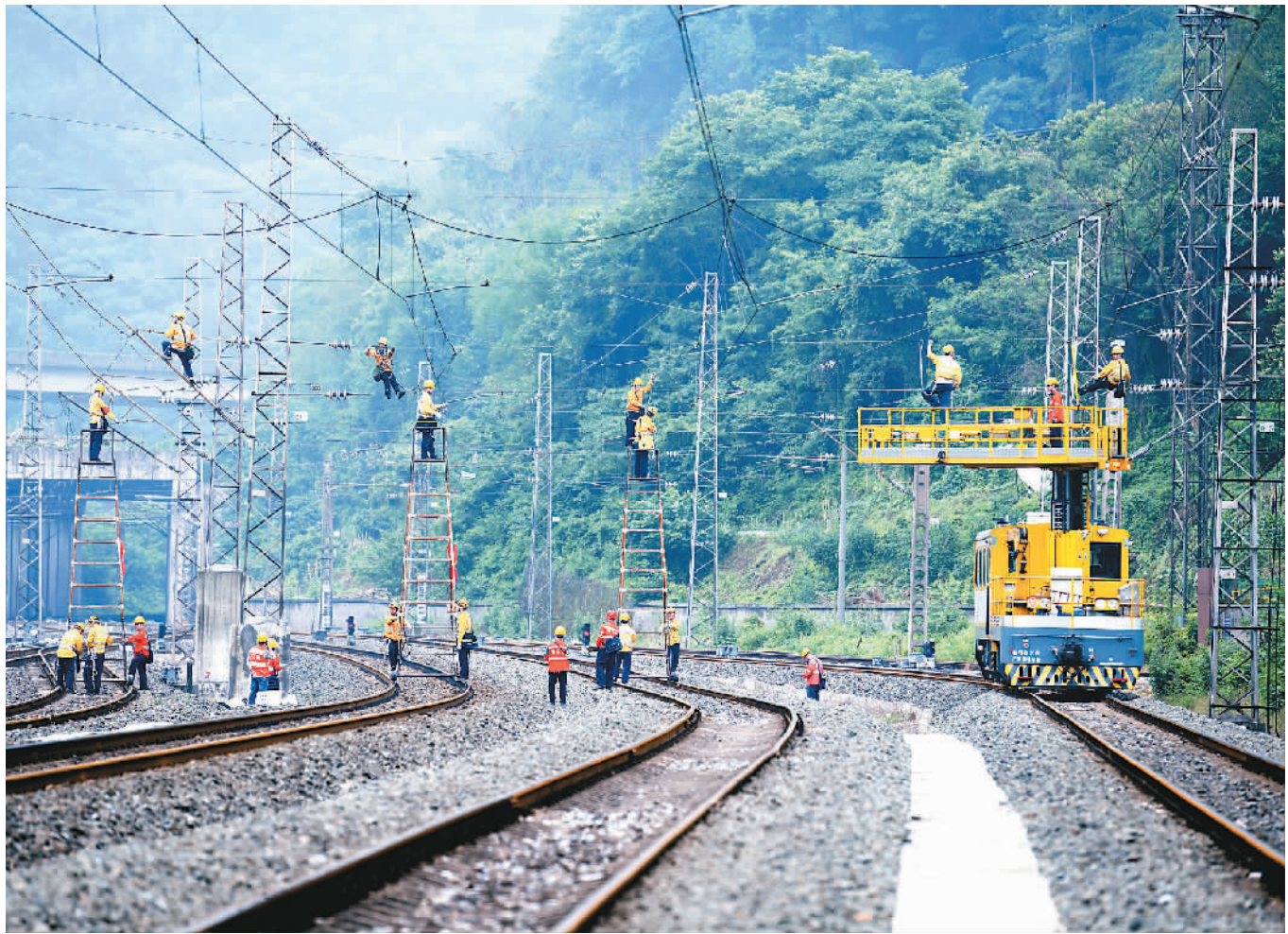
日前，中国铁路成都局集团有限公司宜宾工电段供电维修技术中心组织多名职工，对内昆铁路水富站接触网关键设备进行检修，保障铁路安全畅通。胡志强摄（人民视觉）
