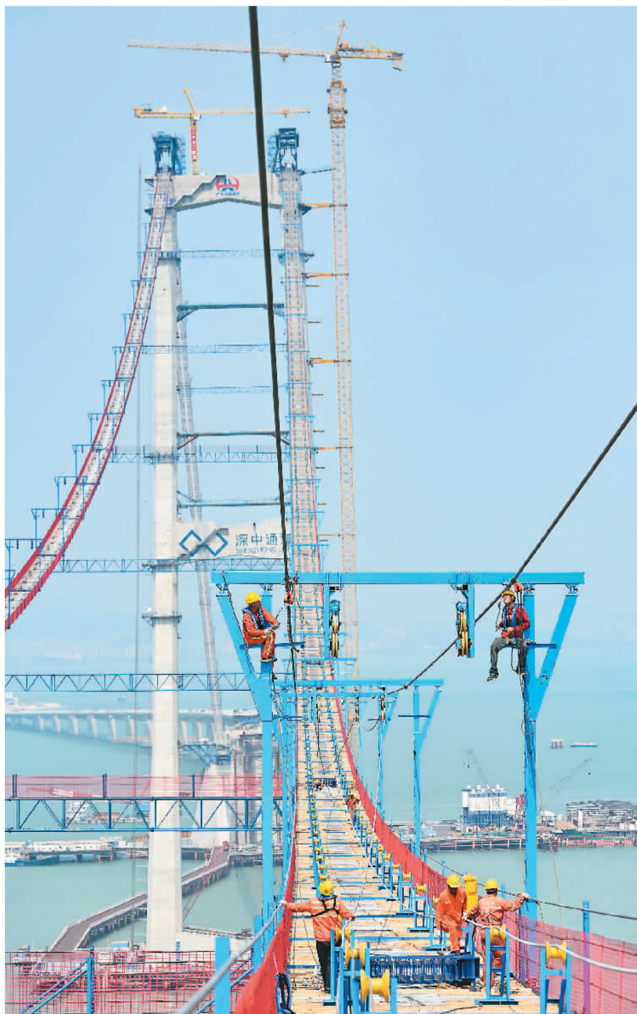
深中通道伶仃洋大桥猫道近日实现全线贯通。该猫道最高点距离海面约270米、最低点距离海面约105米，是世界上海中最高猫道。深中通道是继港珠澳大桥之后，粤港澳大湾区又一个世界级跨海通道集群工程，全长24公里，预计2024年建成通车，届时深圳到中山的车程将从目前的2小时缩短至20分钟左右。
