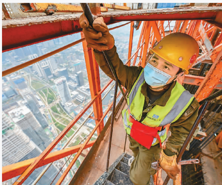
▲ 4月14日，山东国际金融中心大楼施工现场，中建八局二公司项目工人在410米高空检查智能顶升平台。 李永明摄
