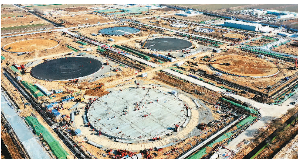
位于山东省东营市东营区的胜利油田东营原油库迁建项目是山东省2022年重大项目，建设罐区库容68万立方米。建成后，将成为智能高效、多能互补、环境友好的一流油库。图为该项目施工现场。刘雪峰摄（人民视觉）
